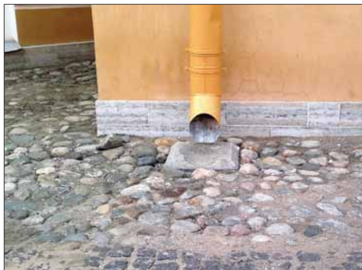
Рис. 20. Разрушение булыжного мощения в местах элементов ливневой системы
